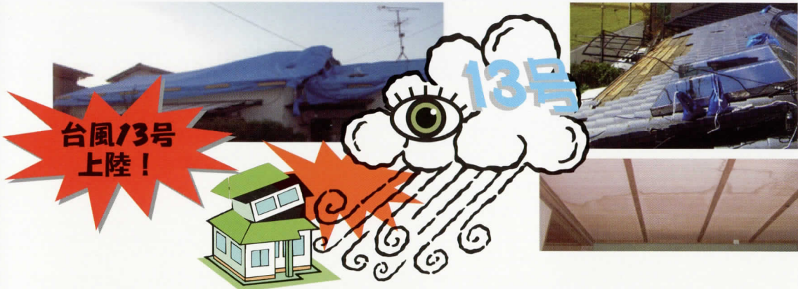
瓦が飛んだ屋根
